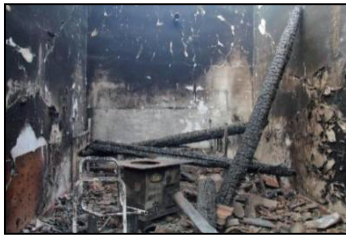
图 12 屋顶坍塌(柳沟乡, VIII 度)
