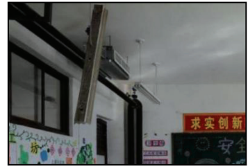
图 19 吊灯脱落(柳沟乡, VIII度)
