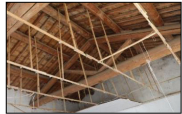
图 8 砖木结构典型屋盖系统(柳沟乡, VIII度)
