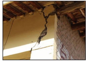
图 6 墙体局部开裂(柳沟乡, VIII度)
