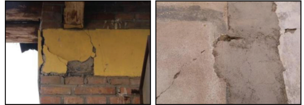
(a) 圈梁混凝土脱落(柳沟乡, VIII度) (b) 构造柱剪切开裂(柳沟乡, VIII度)
