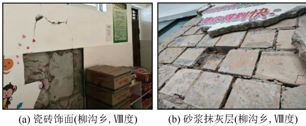
图 17 墙体外饰面脱落
