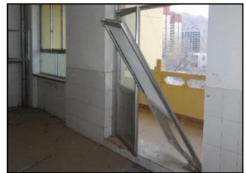
(f) 房门损坏(大河家镇, VIII度)
