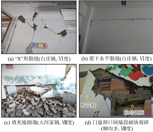
图 16 砌体填充墙破坏
