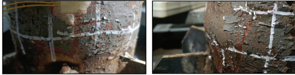
(I) 钢管轻微鼓曲(漆皮掉落) (II) 钢管鼓曲明显(漆皮严重掉落) (b) 塑性阶段
