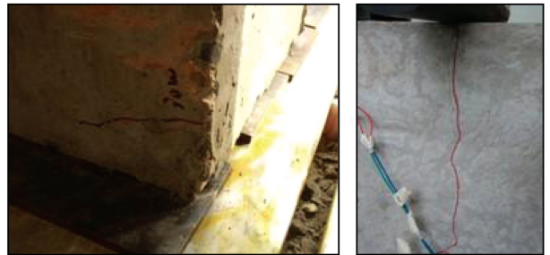
图 6 轴心疲劳荷载作用下的裂缝
